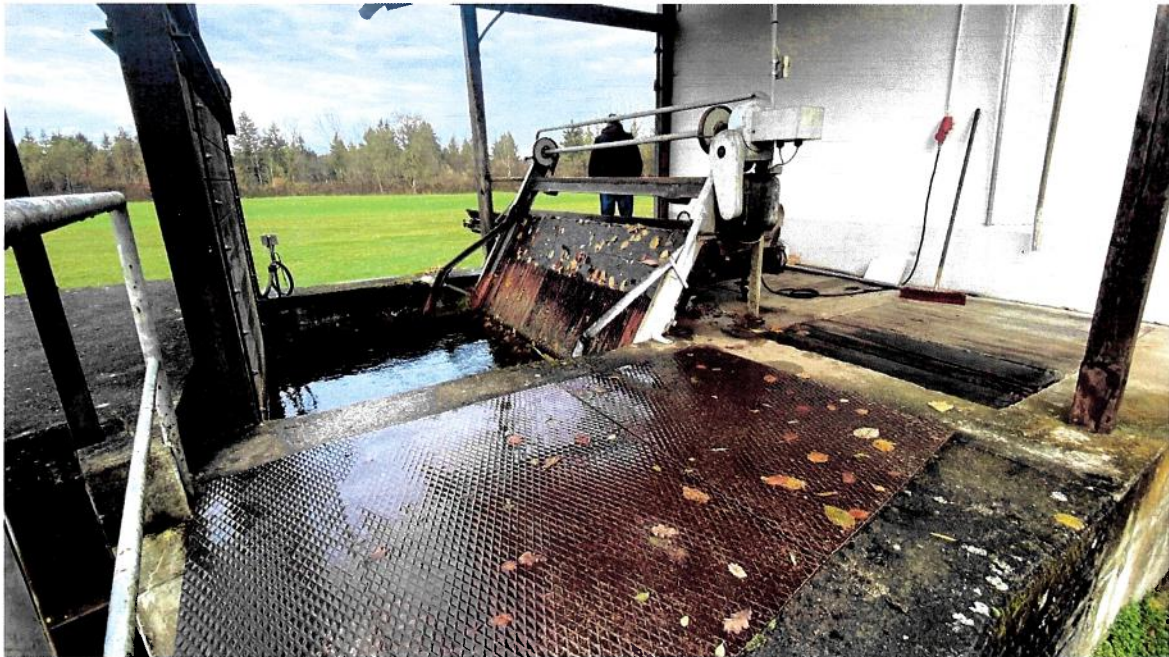
Bild 2: Feinrechen im 2,80 m breiten Turbineneinlauf mit Seilumlaufrechenreiniger, Revisionschütze links im Bild
