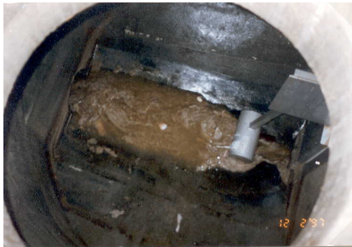
Bild 5: Blick auf die Ablaufdrossel
