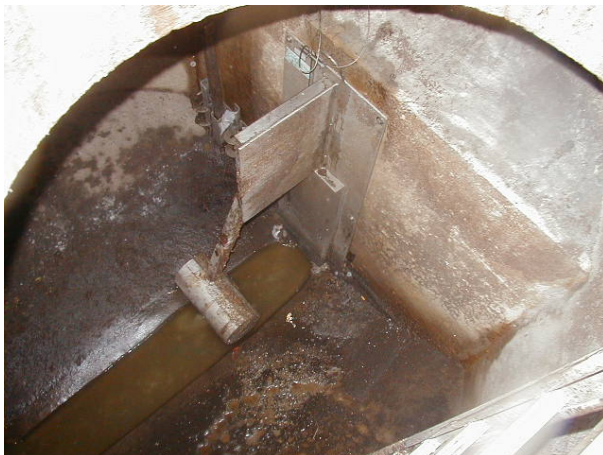
Bild 16: Ablaufdrossel RRB Halsbach
