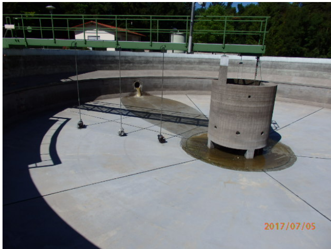
Bild 20: im Jahr 2007 zusätzlich errichtetes Regenbecken
