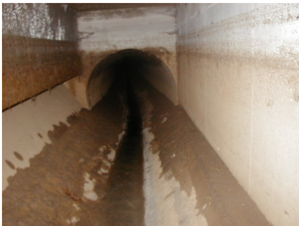
Bild 17: Stauraumkanal, Zulauf zum Trennbauwerk
