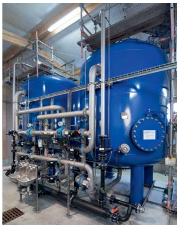
Aktivkohlefilteranlage am Beispiel Alzgern
