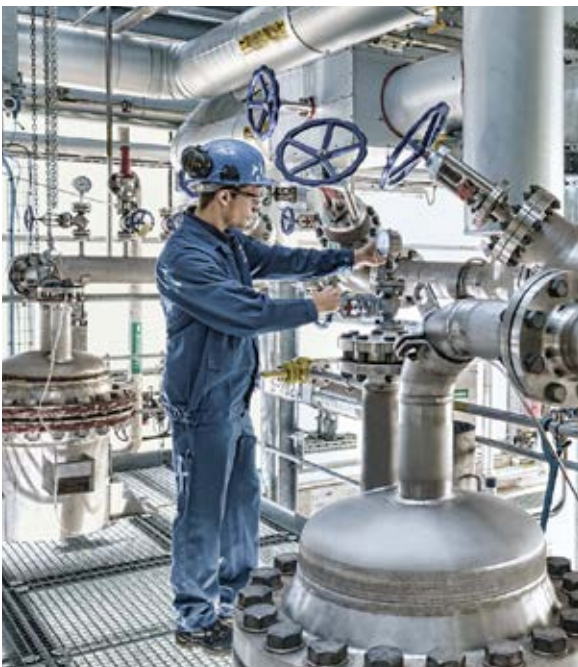
Einblick in unser hochmodernes Ethylenoxid Tanklager
