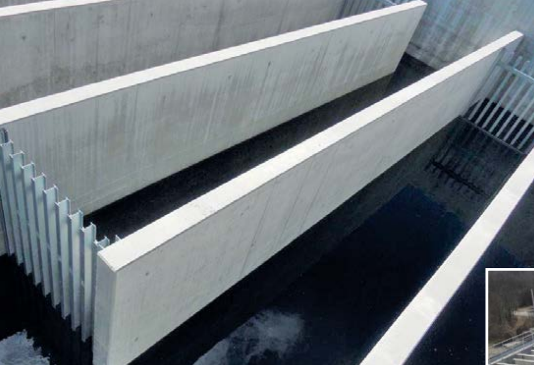
Verzögerungsbecken mit Störkörpern
