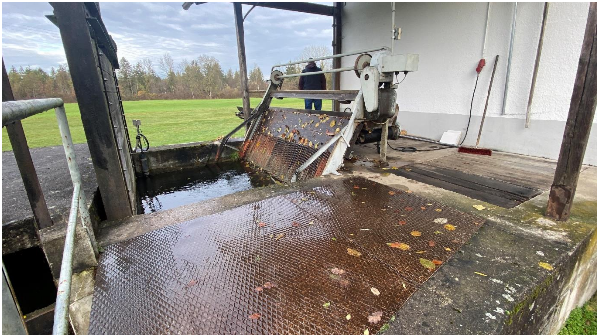
Bild 2: Feinrechen im 2,80 m breiten Turbineneinlauf mit Seilumlaufrechenreiniger, Revisionsschütze links im Bild
