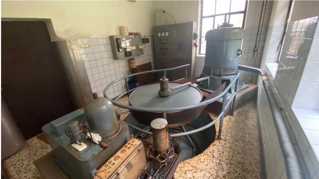
Bild 4: Regler, Riemtrieb, Generator und Steuer- und Schaltanlage
