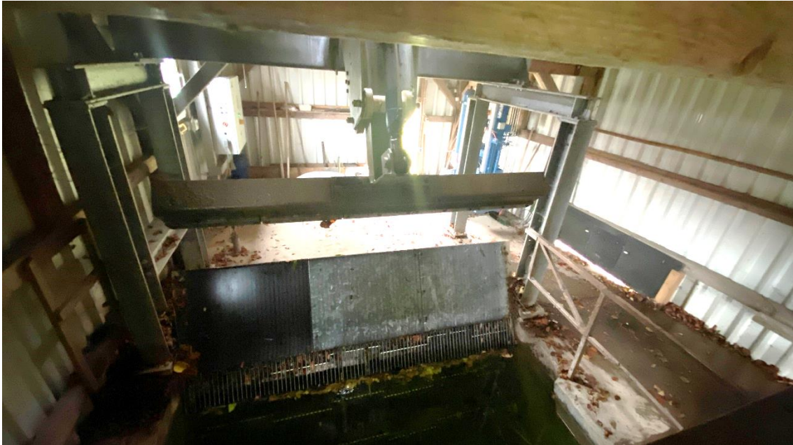
Bild 3: Feinrechen mit Teleskoprechenreiniger
