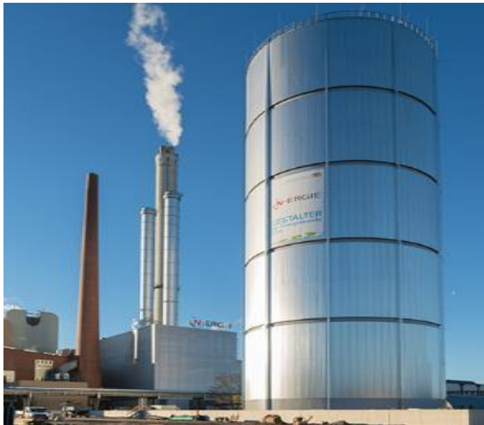
Abbildung 106: Wärmespeicher der Nürnberger Stadtwerke
