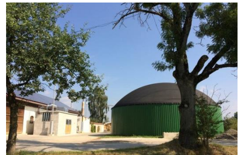
Abbildung 198: Naturland-zertifizierte Biogasanlage der Erzeugergemeinschaft für Energie in Bayern eG (EEB eG), mit einer Leistung in Höhe von 210 kW
