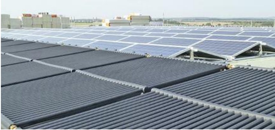
Abbildung 183: Solar-Luftabsorber (vorne) und PV-Dachanlage (hinten), Magazin TGA Fachplaner, 2014
