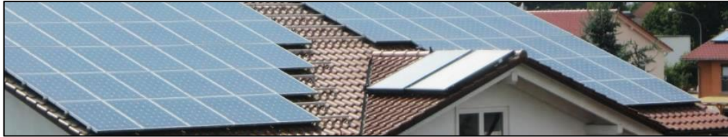
Abbildung 82: Photovoltaik- und Solarthermie-Anlagen auf einem Dach
