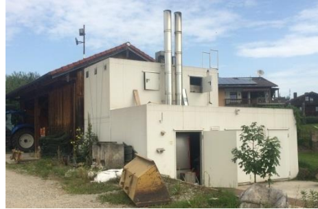
Abbildung 80: Hackschnitzelwerk, Gemeinde Seon-Seebruck
