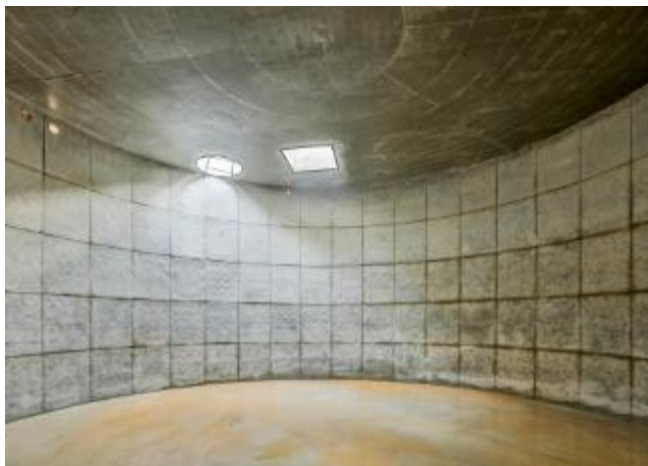
Abbildung 174: Unterirdischer Betonbehälter, Fa. Viessmann
