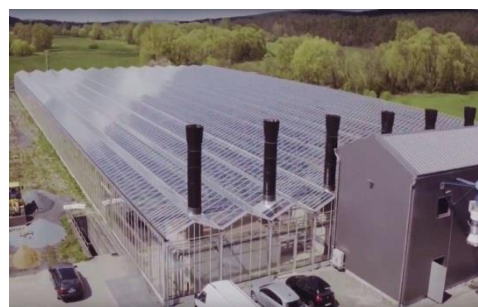
Abbildung 7: Solarthermische Klärschlamm-trocknungsanlage für 300.000 Haushalte in Bayreuth
