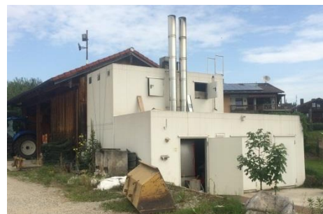
Abbildung 10: Hackschnitzelwerk, Gemeinde Seeon-Seebruck
